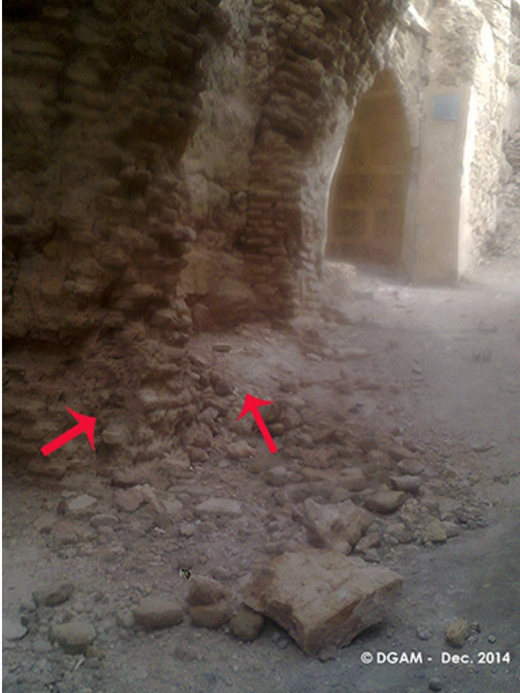
Deterioration of masonry of Qal'at Rahba/Rahba Castle (DGAM).
